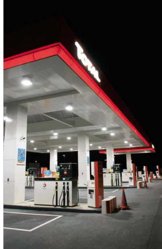
Total töltőállomás – powerLED-láncok
